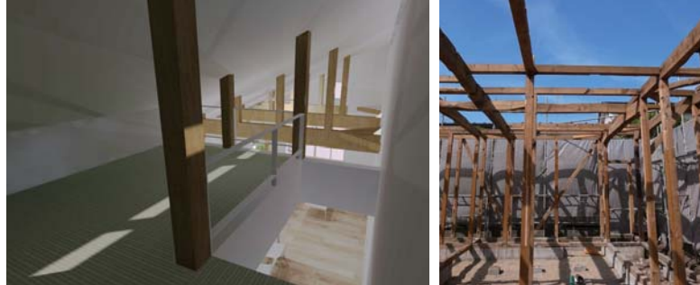
ロフト。西側のトップサイドライトから日が差し込む。解体が終了し露出した構造躯体。
